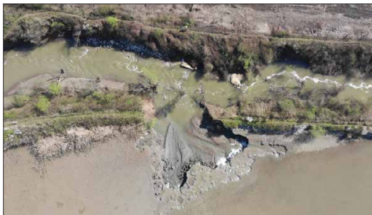
Fotografija 2: Probijeni nasip- Ribnjak Saničani
