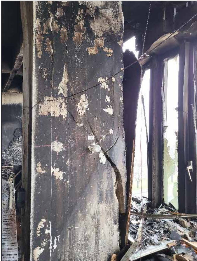
Slika 13: Oštećenja konstrukcija (Foto: Vatrogasna postrojba Zagreb)
