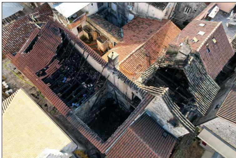
Slika 1: Opožareni objekt 20. 12. 2025. (JVP, 2025)
